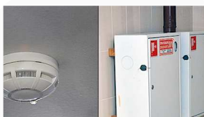
Круглосуточно работающая сигнализация и исправные гидранты
